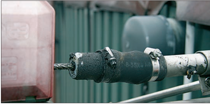
Häufig tritt Gas an der Seildurchführung für die Rührwerke auf. Abhilfe schafft das regelmäßige Fetten der Durchführung.
